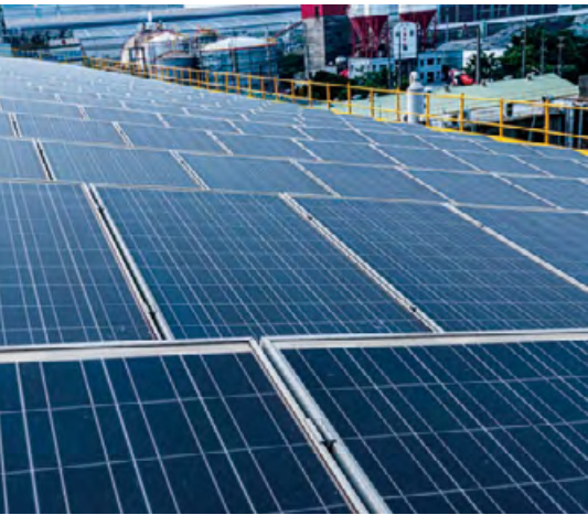
李長榮科技廠房屋頂，全面設置太陽能發電板
