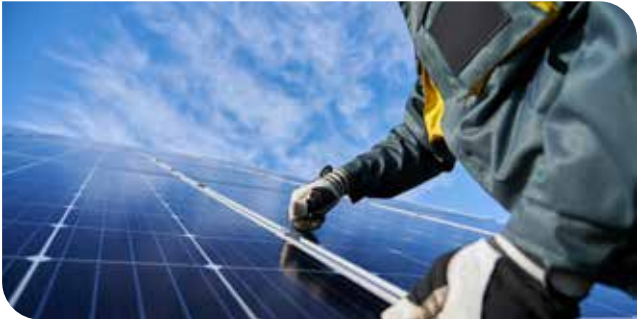
● 李長榮科技廠房屋頂，全面設置太陽能發電板
